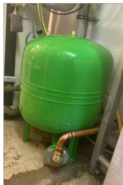
Wäre das Ausdehnungsgefäß im Bienenbütteler Waldbad nicht ausgetauscht worden, könnte es zu einem Komplettausfall bei der Heizung kommen. Foto: Gemeinde Bienenbüttel
