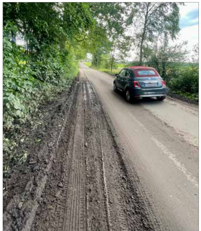
Die Verbindungswege waren den Verkehrsmassen während der B 4-Sanierung nicht gewachsen. Archivfoto: Gemeinde Bienenbüttel
